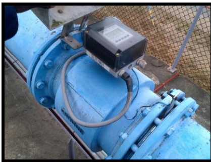
Figuur 15: Foto van de debiet- of flowmeter die het spoelwater registreert
