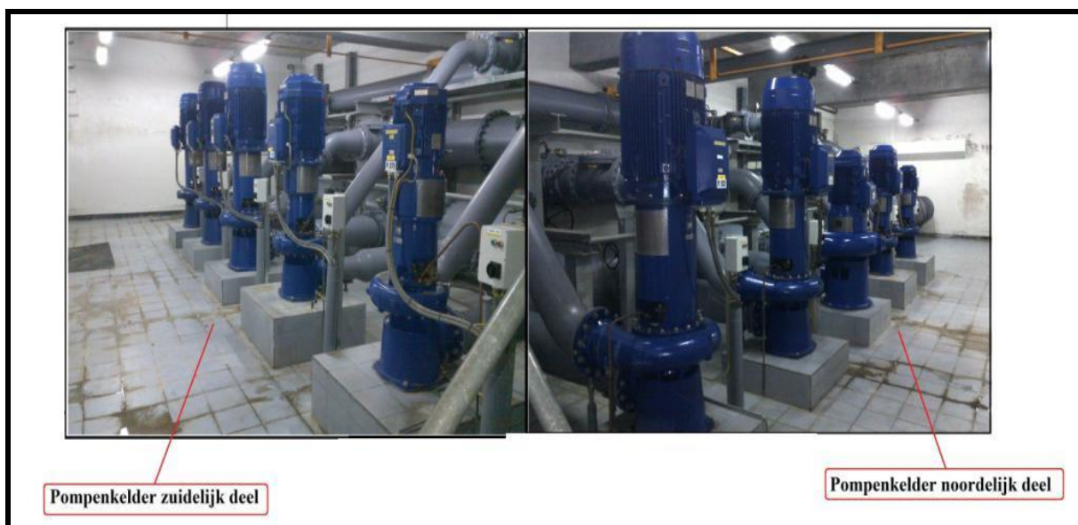
Figuur 13: Foto pompenkelder zuidelijke en noordelijke zijde
